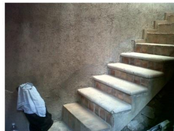
18.a.escaleras que dirigen a la planta alta donde se encuentra una adecuación para un pequeño bar.
