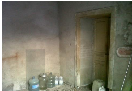
Ilustración 48 Vista sur-poniente del "vestibulo" para uno de los accesos a la habitación 4.
