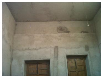
c. vista hacia el norte y hacia la parte superior (otro acceso y ventana), en la parte superior se observa que el muro tiene una parte remetida o no completa.
