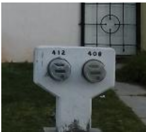
ILUSTRACIÓN 49. MODULO DE MEDIDORES ELECTRICOS
