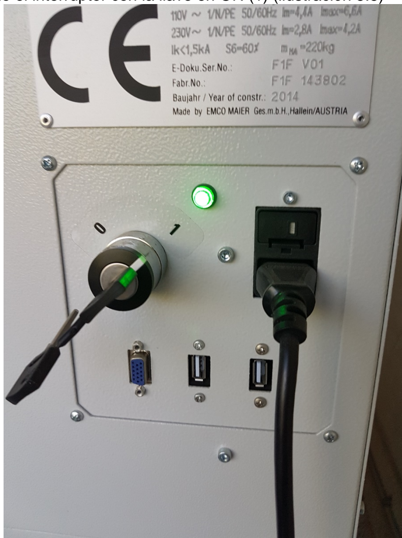
Ilustración 5.5 Interruptor principal (foco verde indica maquina prendida)
