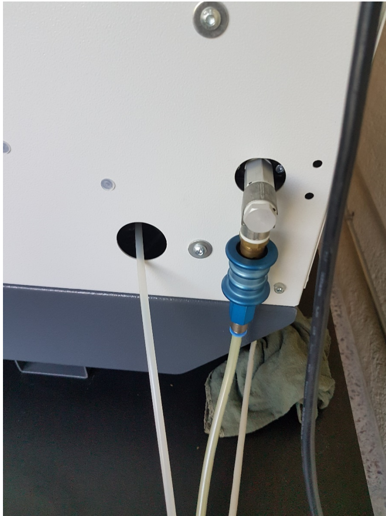
Ilustración 3.15 Válvula principal de aire comprimido
