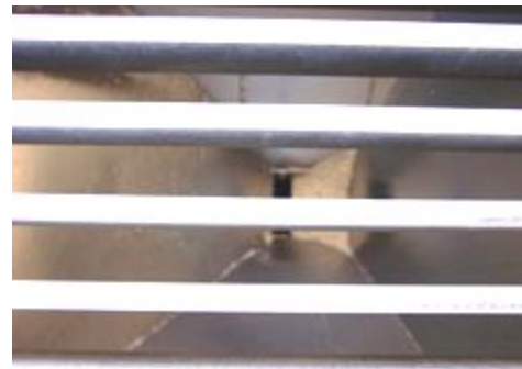
IMAGEN 34. Vista hacia el interior de la fosa ,capacidad 10 Toneladas, donde se percibe el cuerpo piramidal que tiene la fosa con pendientes focales hacia la salida del grano ya sea hacia la secadora de grano o hacia el elevador que suministra el producto a los silos
