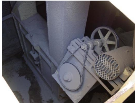
IMAGEN 32. Base del elevador donde se distinguen los dos apoyos que describen anteriormente; bajo nivel de piso, donde se encuentra la conexión mediante tubería con la fosa de recepción y se aprecia el motor eléctrico de 20 H.P. capacidad de 50 a 55 T/H
