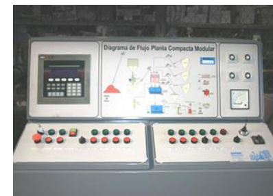
IMAGEN 56 Panel de automatización productiva
