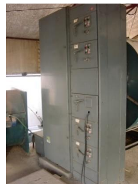
IMAGEN 42. Tablero de control eléctrico de cada una de las secciones de la planta
