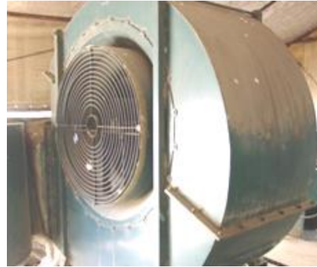
IMAGEN 40. al interior del silo. Los ventiladores que tienen un diámetro de 30" y son impulsados por un motor eléctrico de 25 H.P. Dichos ventiladores trabajan de forma alterna porque el silo tiene que ser alimentado de aire las 24 hrs del día.
