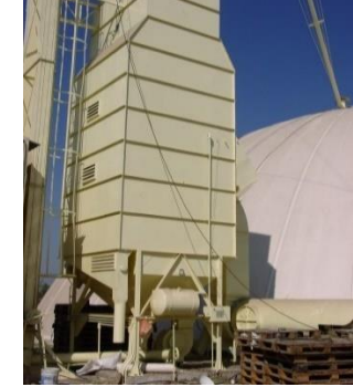
IMAGEN 36. Se aprecia la instalación de gas natural necesario para el funcionamiento del equipo.
