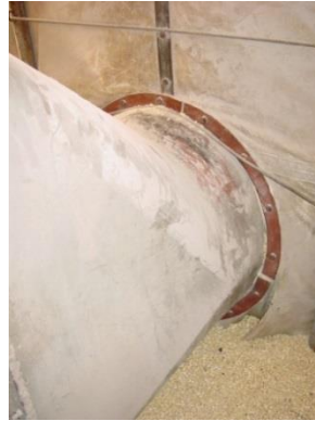
IMAGEN 39. Salida de aire que es inyectado por el ventilador
