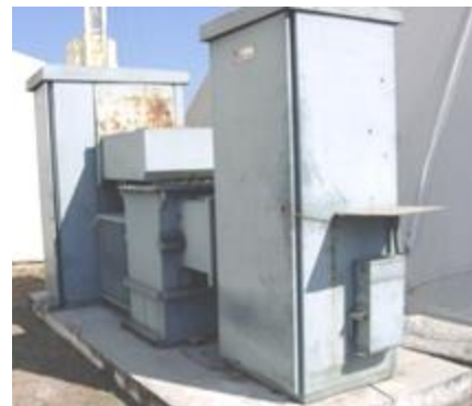
IMAGEN 41. Transformador eléctrico de 300 KVA o 13,200 Volts, enfriamiento a base de aceite. Esta directamente conectado con el panel de control eléctrico que subdivide la electricidad en diferentes secciones en función de las necesidades eléctricas: Alumbrado general 220 V a 127 V, motores eléctricos de la maquinaria general 440V a 224V que corresponde a una fase trifásica, instalaciones de oficina: 127 V
