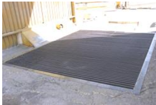
IMAGEN 33. Parrilla de seguridad elaborada con placa de acero de 1 1/4" por 6" a cada 8 cm, la cual permite el tráfico de camiones que descargaran el grano, también funciona como seguridad para evitar la caída de objetos no deseados dentro de la fosa.
