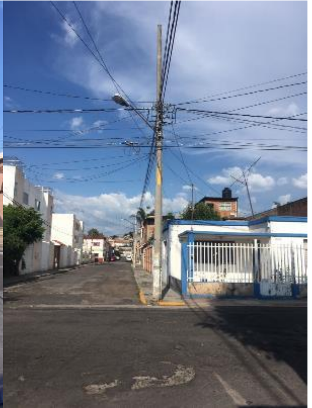
Imagen 4.43. Servicio de Cable
