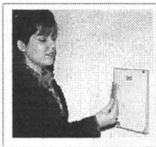
(Lectora y tarjeta magnética del control de acceso)
