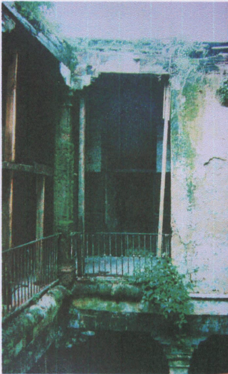
Pasillo y parte del muro de la habitación que se encontraba sobre el cubo de la escalera en la Planta Alta.
