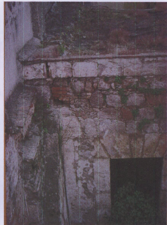
Muro y azotea, podemos ver la vegetación que crece en la azotea.
