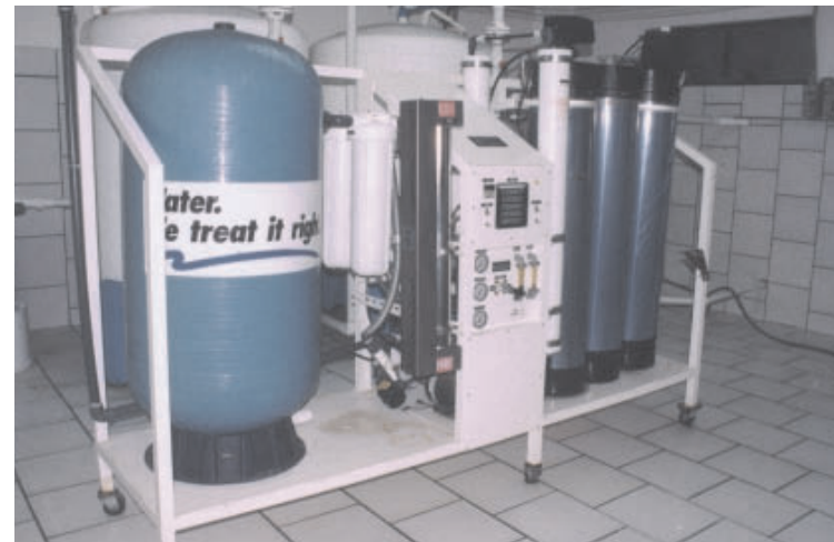
Maquinaria para el procesamiento de purificación del agua
