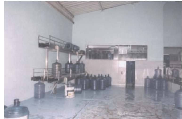
Instalaciones de la planta
