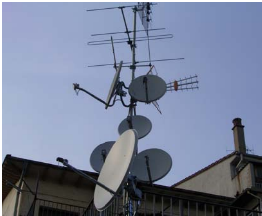
Fig. 21.1 Antenne e apparati.
