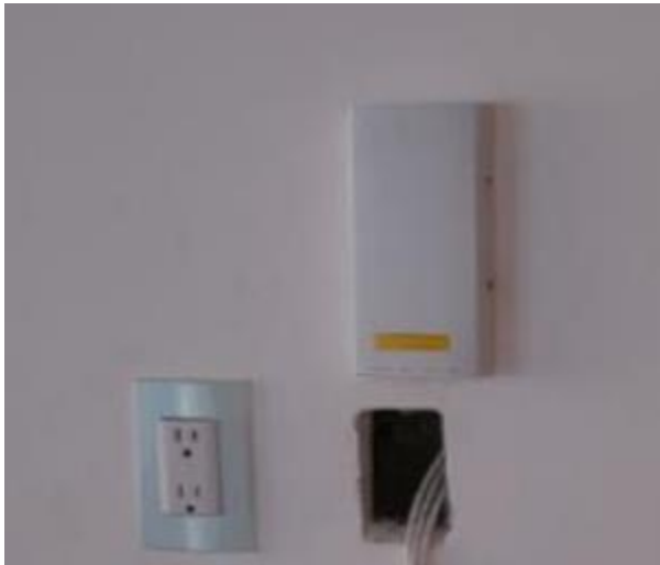
Instalación de AP en Habitaciones
