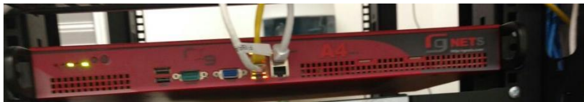
Foto del RGnets Instalado
