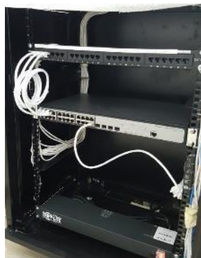
Foto del SW06 Instalado al IDF4
