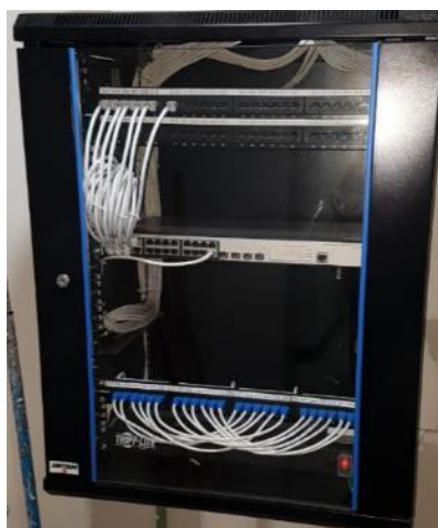
Foto del SW03 Instalado en el IDF 1
