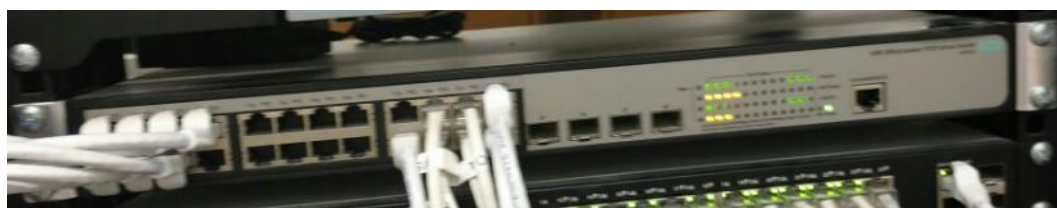
Foto del SW01 Instalado
