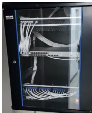
Foto del SW04 Instalado en el IDF 2
