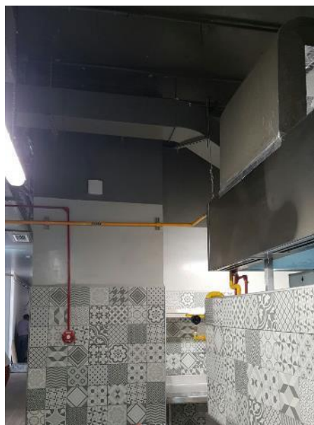
Instalación AP Cocina
