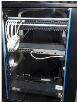
Foto del SW05 Instalado al IDF 3
