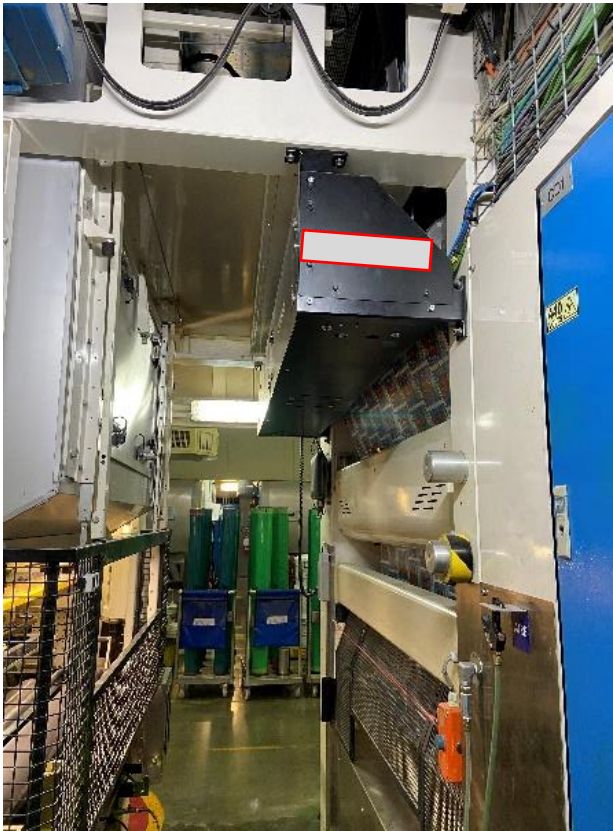
Ilustración 18 Marco para el sistema de centrado de impresión ya instalado con guardas de color negro.
