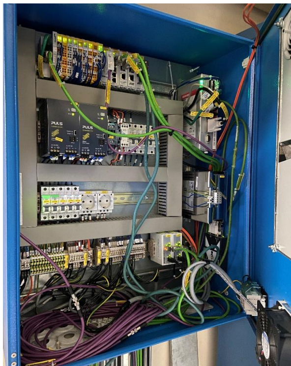
Ilustración 19 Interior del gabinete principal CBY1. Se ven los cables verdes de comunicación PROFINET y los cables morados para la comunicación con el protocolo CAN Bus.
