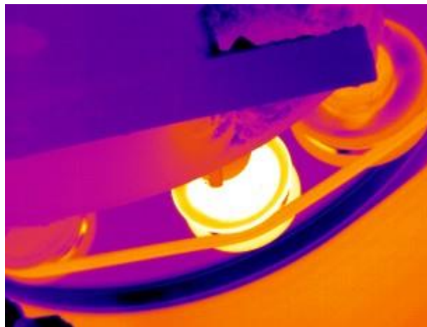
Ilustración 46 Imagen termográfica de poleas donde se observa que la polea del centro irradia más calor.
