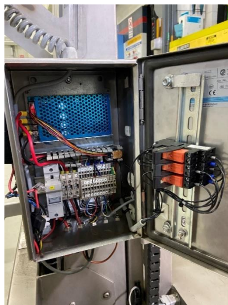
Ilustración 39 Gabinete con nuevo circuito de control.
