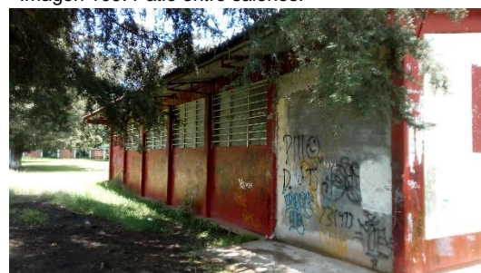
Imagen 111. Taller de electricidad.
