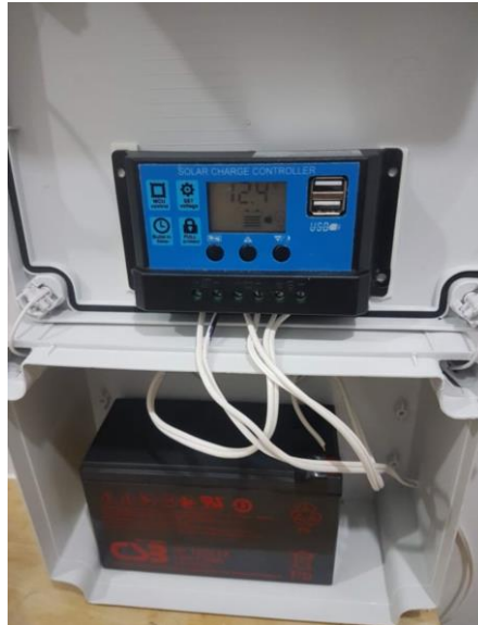
Figura 2.49 Caja de control
