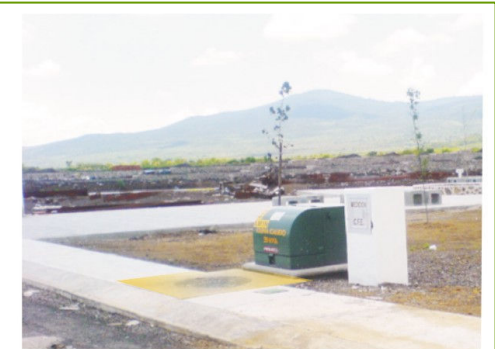
Imagen 108 : Instalación eléctrica subterránea en el predio CFE, en la imagen se puede ver el transformador, registro y medidor
