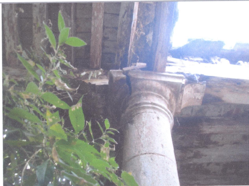
Foto 5 fractura del capital de la columna, espacio 15 en el enmarcamiento y piso
