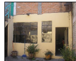
FIG. 28 Integración. Filtración por muros Piso de concreto simple
