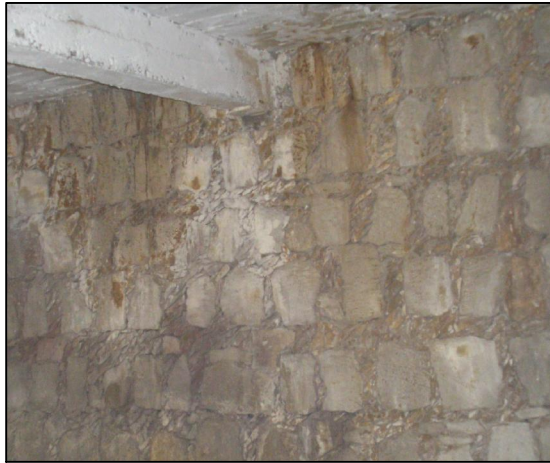
FIG. 17 Alteración de espacio Alteración de sistema constructivo losa de concreto Filtración de humedad Sales Incuria
