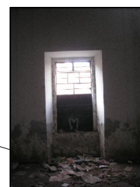
FIG. 10 Desprendimiento de aplanado Basura
