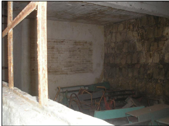
FIG. 16 Alteración de espacio Filtración de humedad por los y muros Sales Sistema Constructivo contemporáneo Incura Cambio de color de la cantería a color amarillo Oxidación de la herrería
