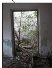
FIG. 9 Incuria Filtración de humedad
