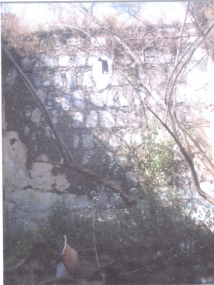
Foto 3 deterioro en el muro norte. Proliferaciones de líquenes. Espacio 11, plantas mayores
