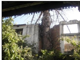
FIG. 84 Cubierta fracturada Filtración
