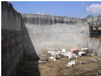
FIG. 62 Falta estructural (al presentar grietas) Agente entrópico (incuria) Ausencia de techo (filtración)
