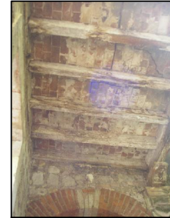
FIG. 52 Cubierta fracturada Filtración
