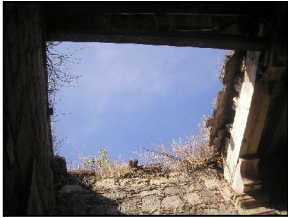
FIG. 49 Cubierta colapsada Presencia de vegetación
