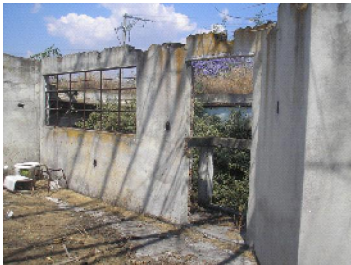
FIG. 61 Agente entrópico (hazme) Filtración de la lava de concreto
