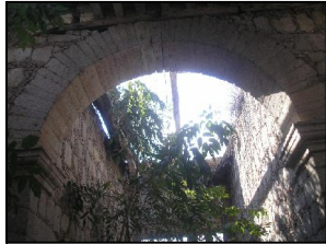
FIG. 6 Pérdida de cubierta Pérdida de aplados
