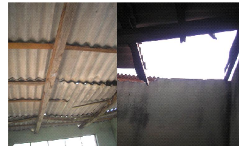
FIG. 63 Techo no apropiado (en pélimas condiciones) Filtración
