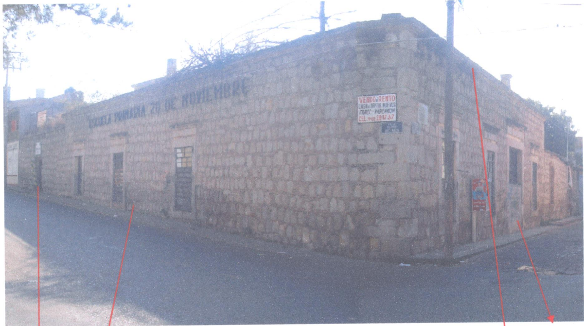
Foto 1 vista general de los deterioros sufridos en la fachada
