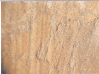
Fig. 1 Aspecto de pintura a la cal con color ocre.
