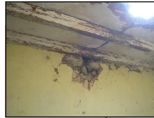
FIG. 33 Cubierta colapsada y fracturada Desprendimiento de muro
