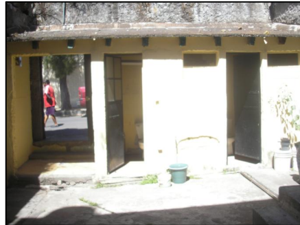
FIG. 28 Aplanados agrietados e bofas Alteración espacial Deterioro en muros Deterioro en pisos
