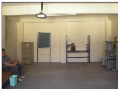
FDE. 24 Integración. Filtración por muros Piso de concreto simple
