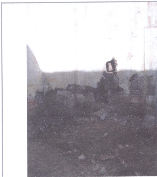
Fig. 3 oquedades muro y piso
