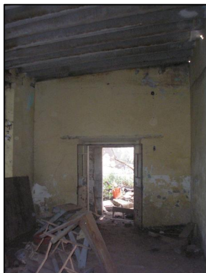
FIG. 28 Alteración en la cubierta Fijación Desprendimiento de aplaste
