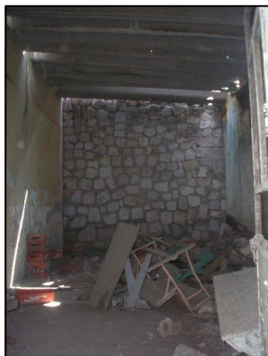
FIG. 30 Desprendimiento de aplaste Barras
