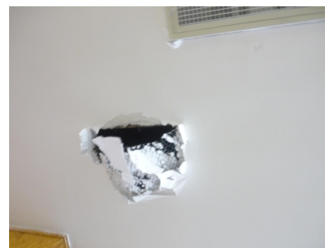
Fig. 82 ESTADO DE CONSERVACIÓN.
