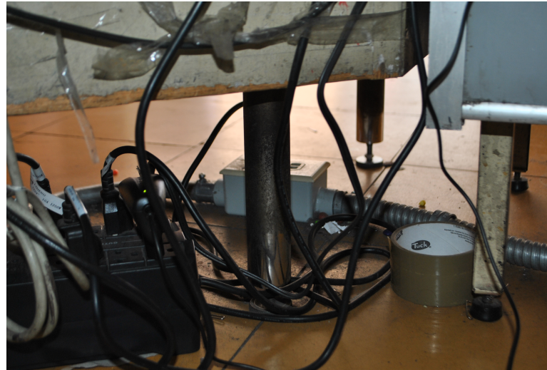
Imagen 60. Cables y tubos de instalación eléctrica expuestas en planta baja, en los mostradores.
