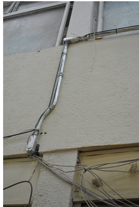
Imagen 64. Instalación eléctrica expuesta subiendo a segunda planta
