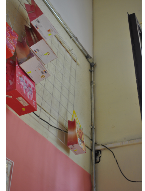
Imagen 61. Tubo de instalación eléctrica expuesta.
