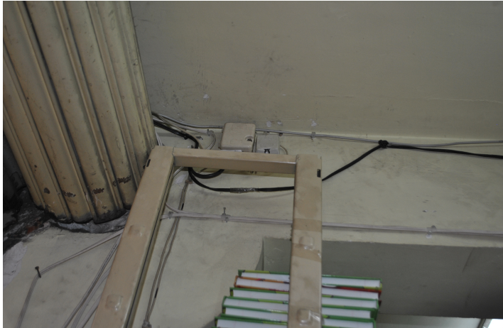
Imagen 62. Cable de instalación eléctrica, recorriendo todo el local.
