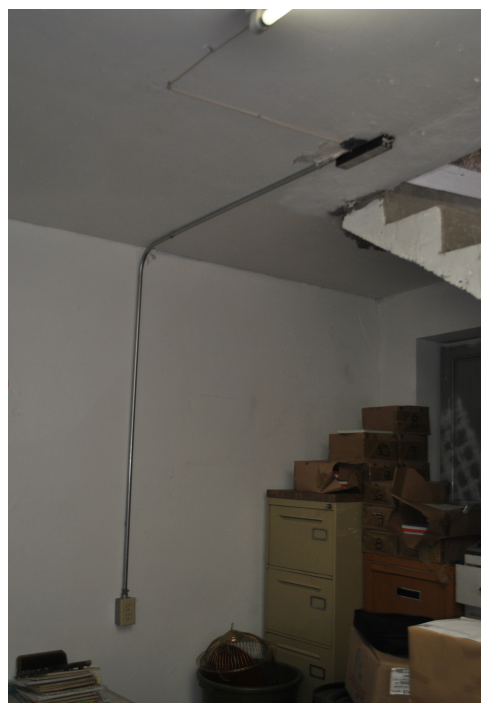
Imagen 67. Salida de instalación eléctrica.
