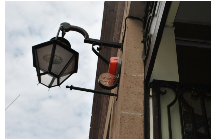
Imagen 65. Alarma unida con los demás locales.
