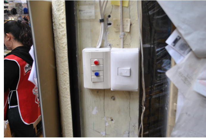
Imagen 63. Timbre y alarma. En planta baja en mostrador escolar.
