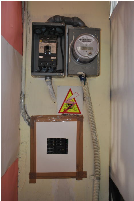
Imagen 59. Centro de carga, se encuentra en la entrada del lado derecho.
