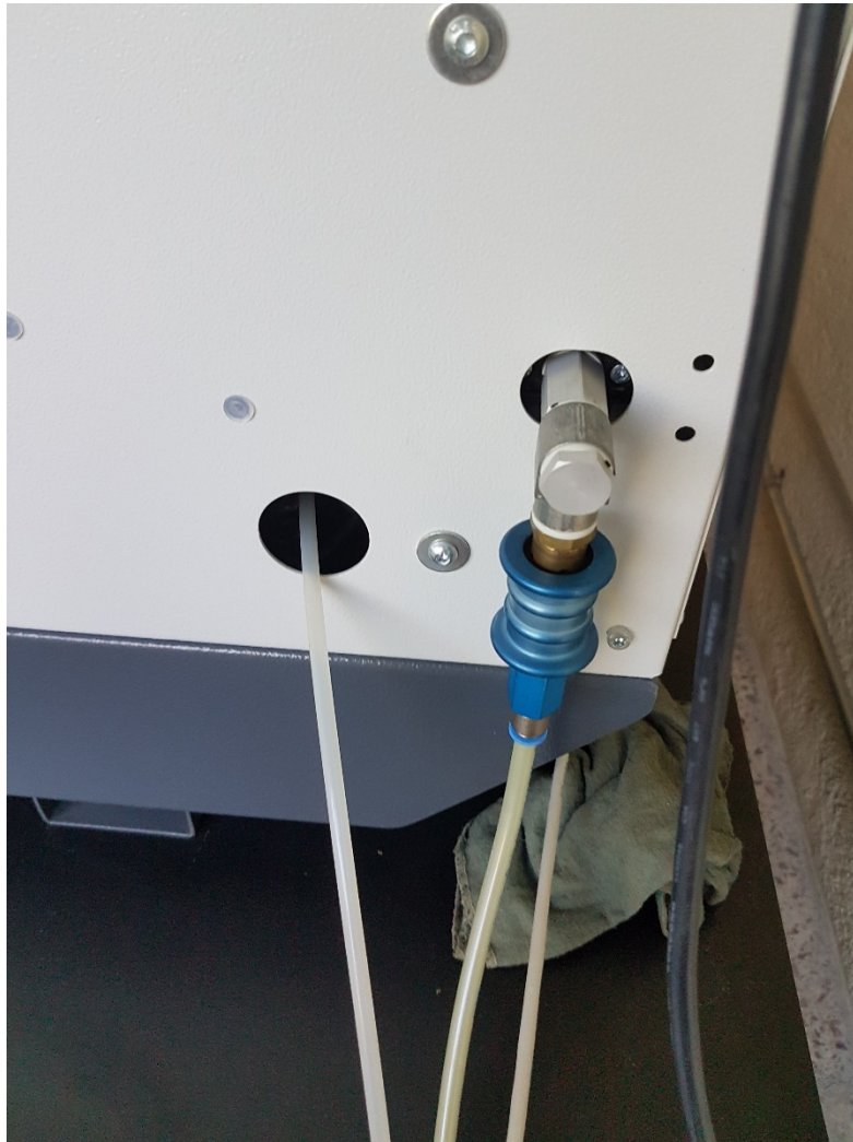
Ilustración 3.15 Válvula principal de aire comprimido
