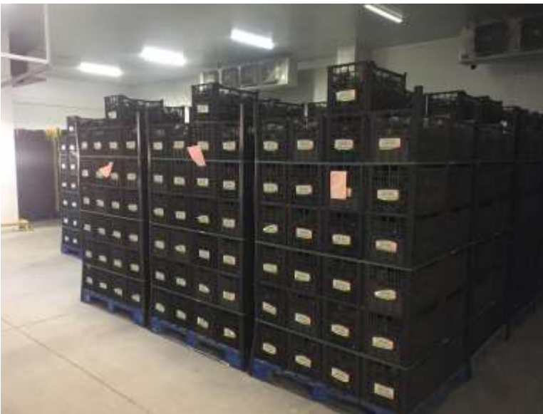
Figura 61. Cámaras de frío dentro de la nave industrial, que permiten el almacenamiento de la fruta, asimismo un sistema de inventario.
