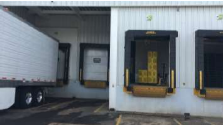
Figura 41. Zona de carga y descarga de fruta con andenes sellados que permiten preservar la cadena de frío.
