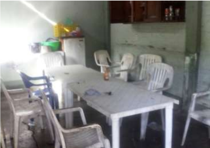
Figura 34. Comedor para personal de producción en malas condiciones, y sin lo necesario para comer adecuadamente.
