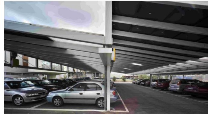
Ilustración 31 Parking fotovoltaico pluvial, produce energía, proporciona sombra y recoge el agua de lluvia obtenida de http://ecoprojecta.es/imprenta-regional-murcia/
