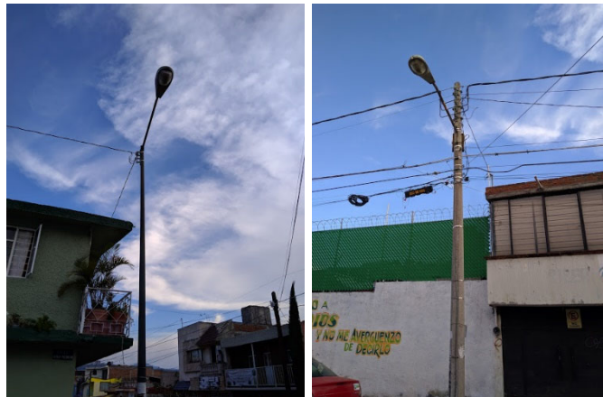
Imagen 23. Poste de acero y poste de concreto. Fuente: Creación propia.
