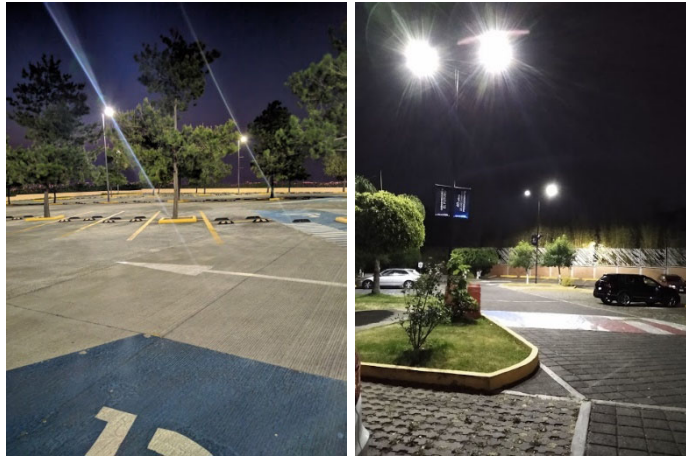
Imagen 28. Ejemplo de alumbrado exterior con LED en estacionamientos. Fuente: Creación propia.
