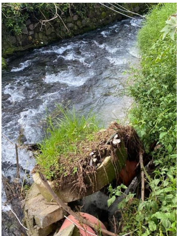
Imagen 4. Contaminación río Los Conejos. Fotografía de elaboración propia
