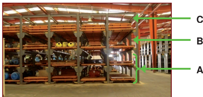
Imagen 13 Racks con subdivisión A, B y C.
