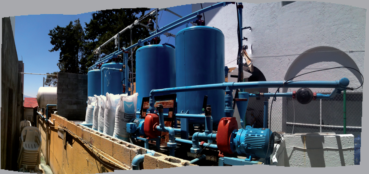
Planta de tratamiento de aguas jabonosas, fotografía del autor. 2011
