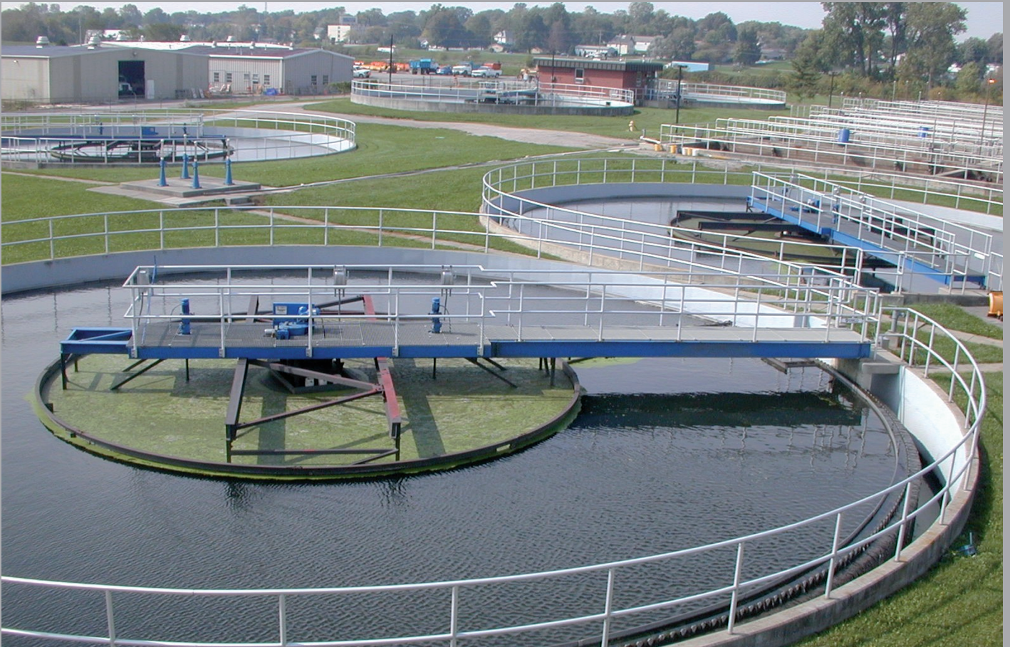
Planta de tratamiento. Purificación de agua. 2006
